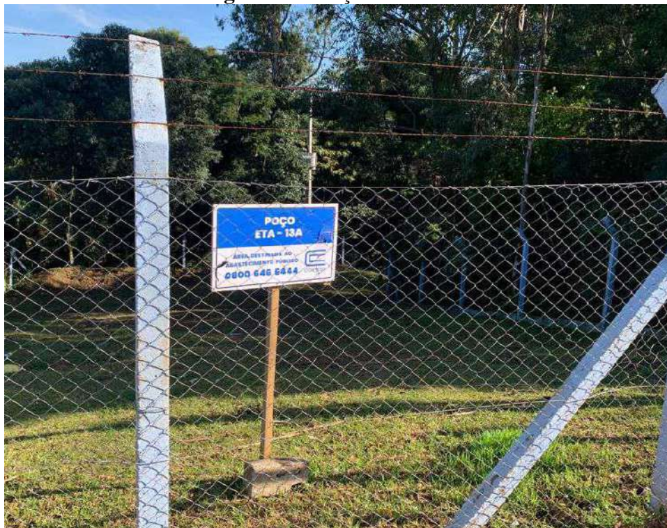
Figura 15 – Poço e ETA-13A
