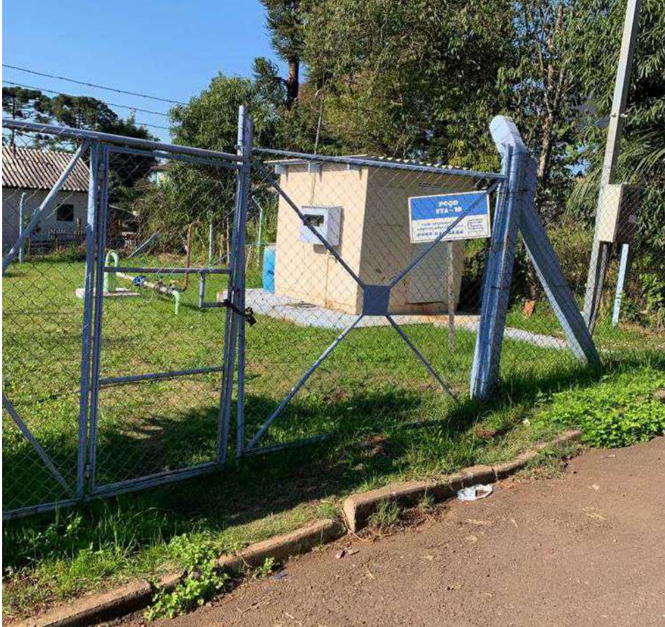
Figura 14 – Poço e ETA-10
